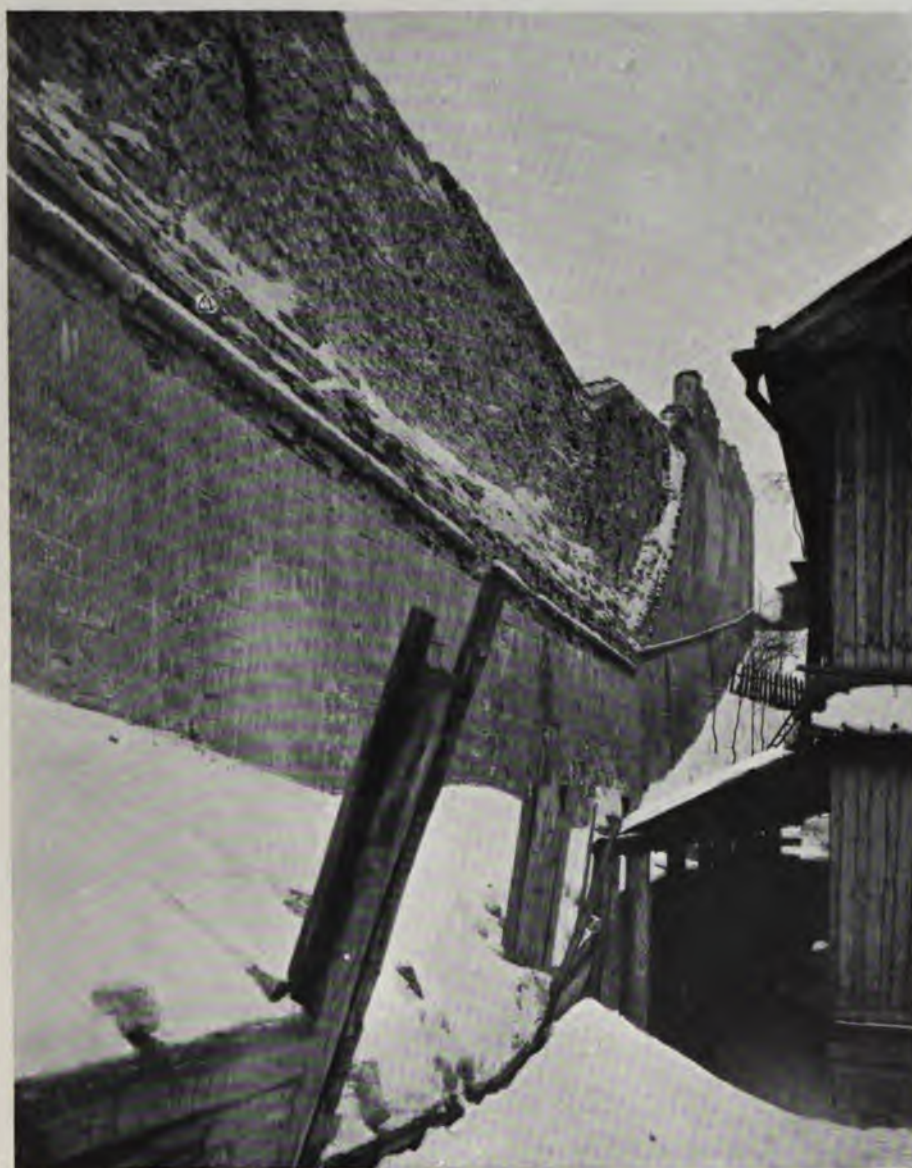
Разрушеніє стѣны путемъ отслаиванія.
